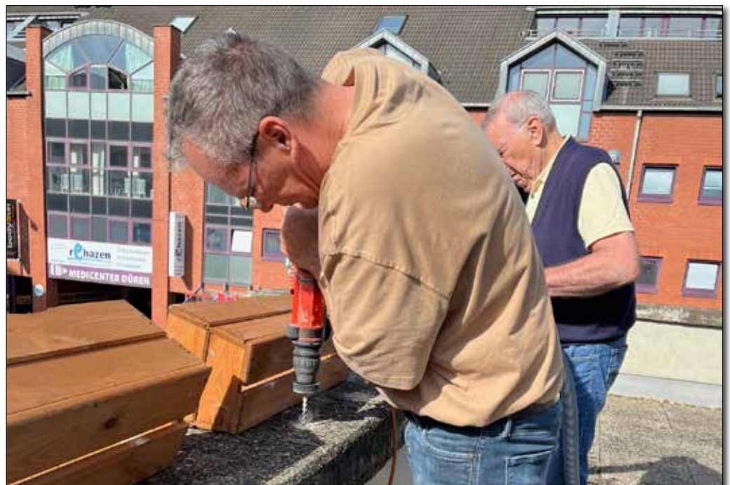
Herbert Reiter und Rolf Terkatz montieren Blumenkästen auf der Balustrade der Terrasse – zur Anpflanzung diverser Kräuter und Blumen und zum Schutz der sehr lebhaften Kinder ...
