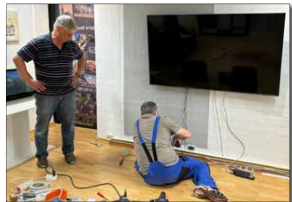
Axel Leroy und Heiner Effertz installieren eine Medienstation.
